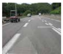
舗装損傷状況
