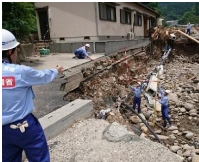
河川被害状況の調査
