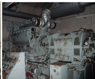
航空保安施設用予備発電設備の調査
