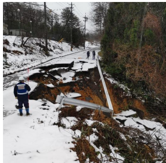
道路被害状況の調査
